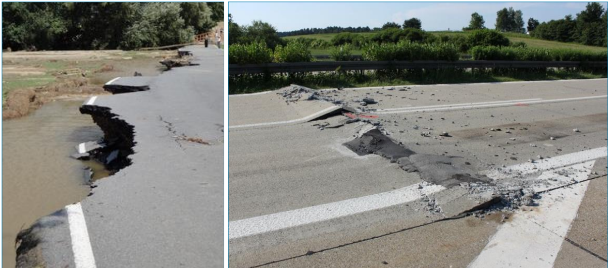
Abbildung 54 (links): Unterspülte Straße bei Bautzen (Quelle: Julian Nitzsche / pixelio.de)
